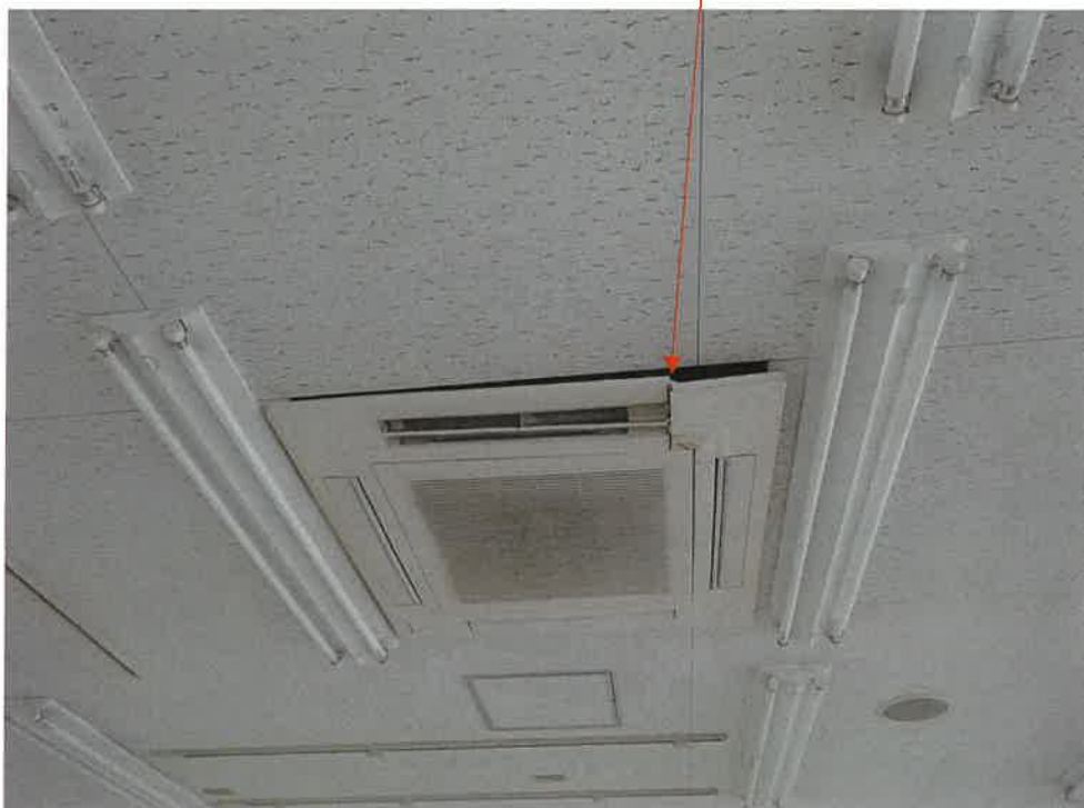
パネルの損傷
