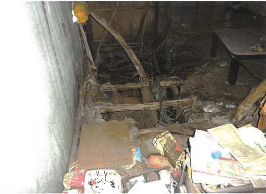
⑩床崩落箇所
