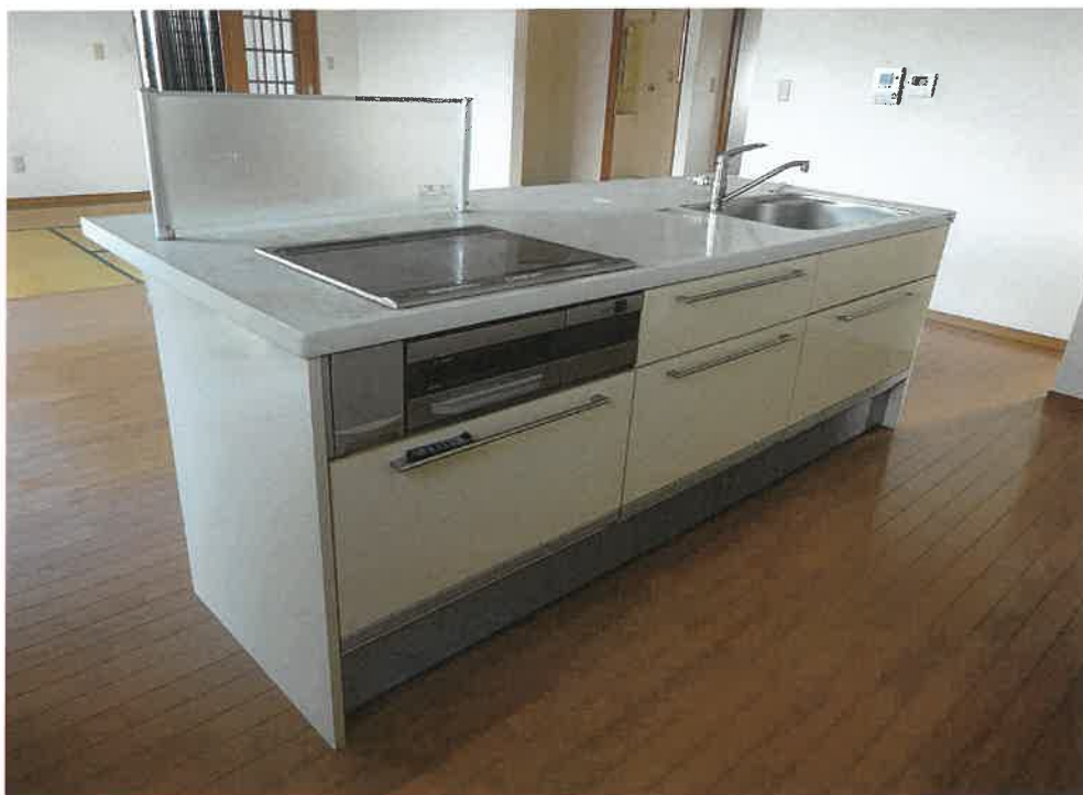
写真16 補修途中で放置された部屋の状況
