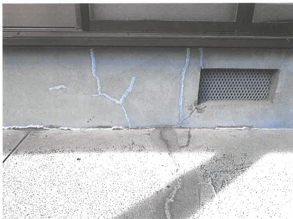
物件4 基礎・犬走りのヒビの補修跡
