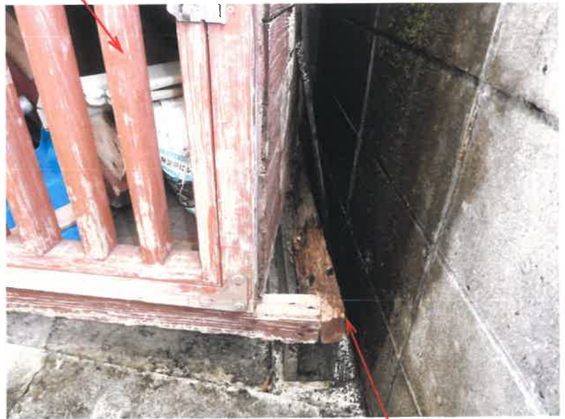
シロアリの被害箇所
