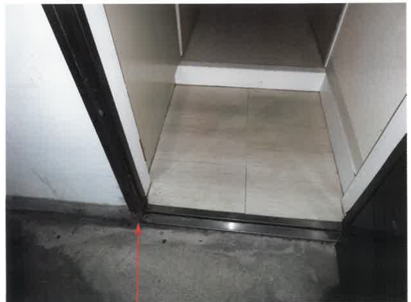
錆で腐食した箇所 ( 27 枚目 )
