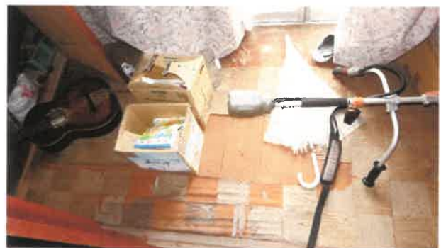
くれ縁床の状況
