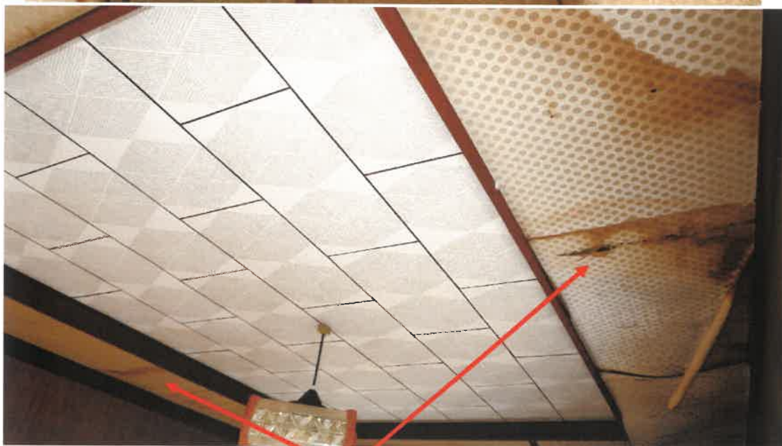
雨漏り跡・天井板破損の状況
