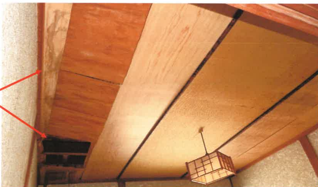
天井板の破 損等状況
