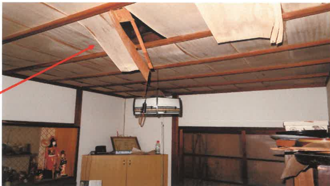
天井板の 破損状況
