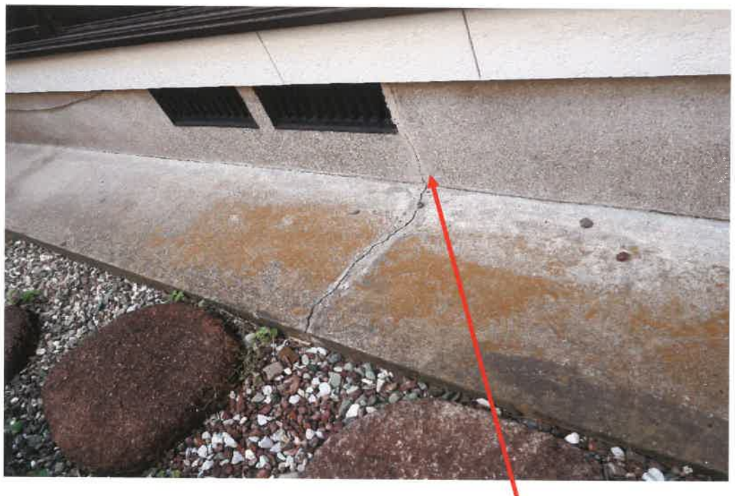
基礎部分のひび割れの状況
