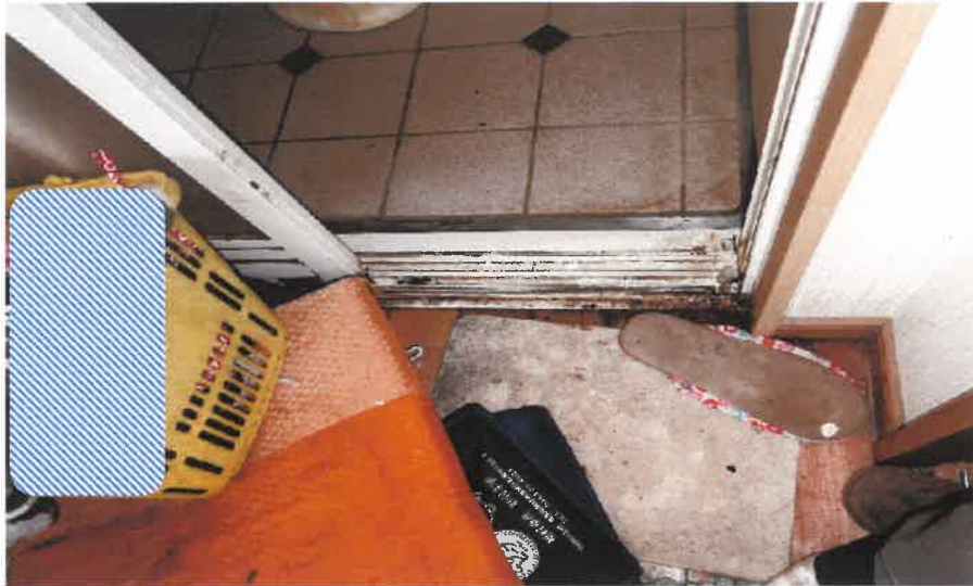
脱衣所床 の状況
