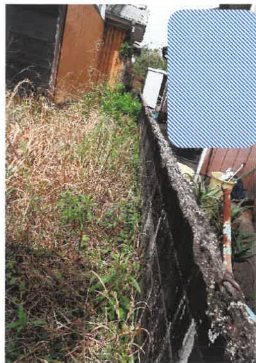
写真㉕ ブロック積の状況
