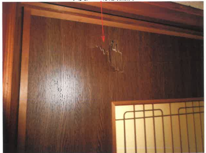
木製戸の破損箇所
