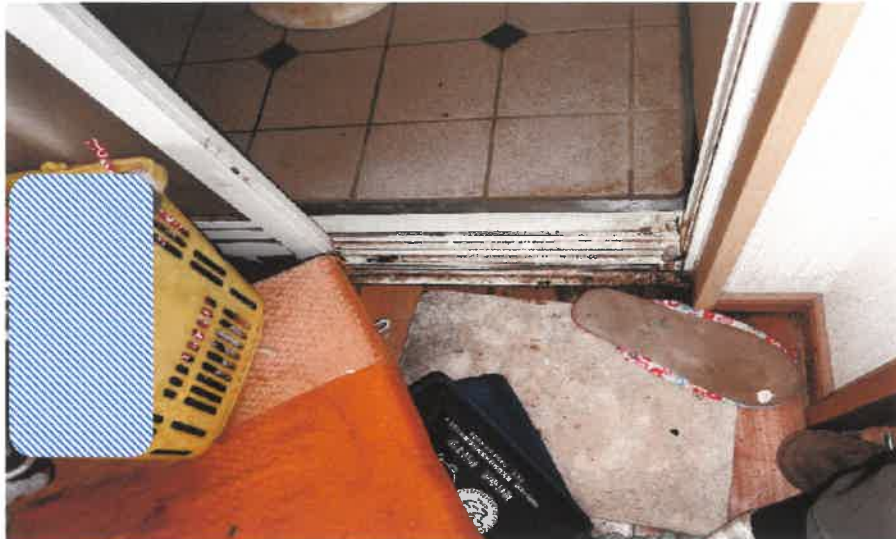
脱衣所床 の状況
