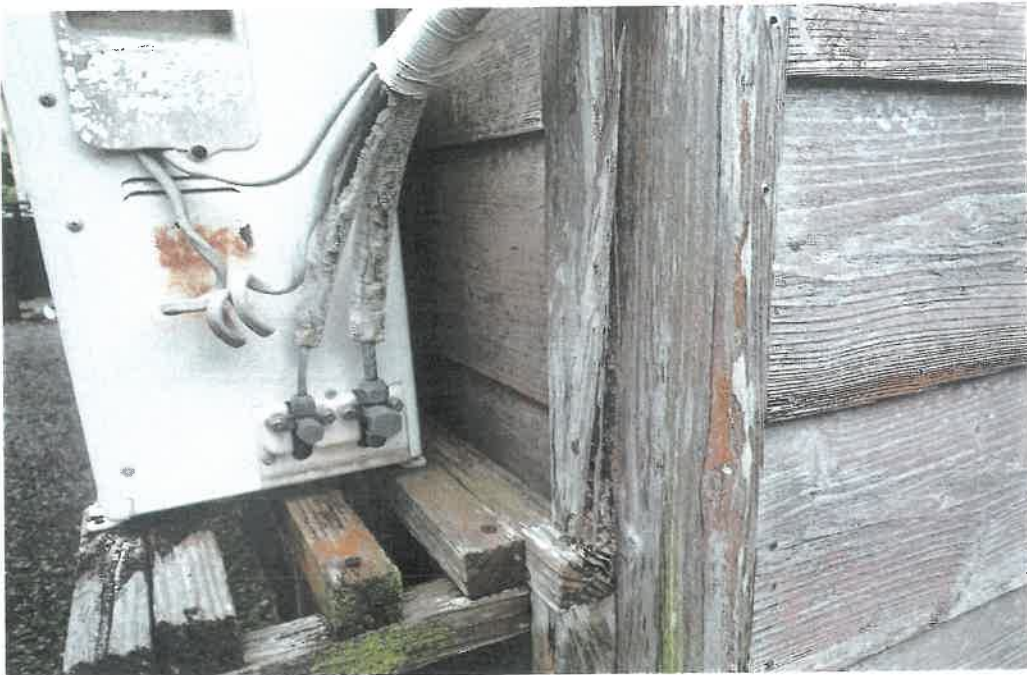
シロアリによる侵食の状況
