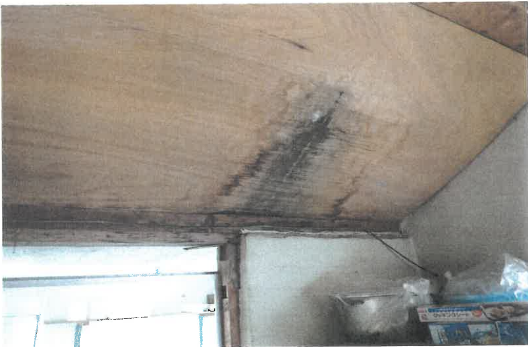
同上(雨漏り痕の存在)
