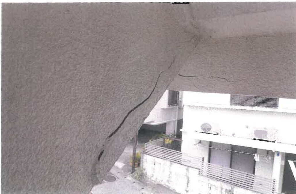
外壁コンクリート欠落状況
