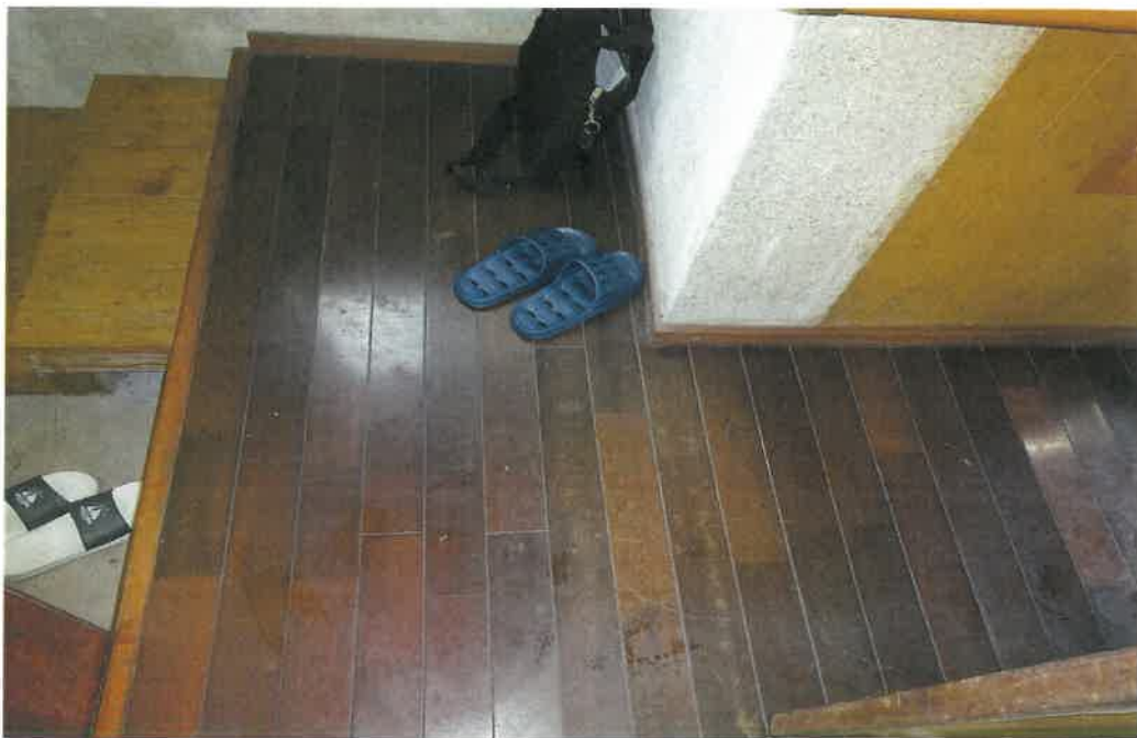
物件3(床板の軋みあり)
