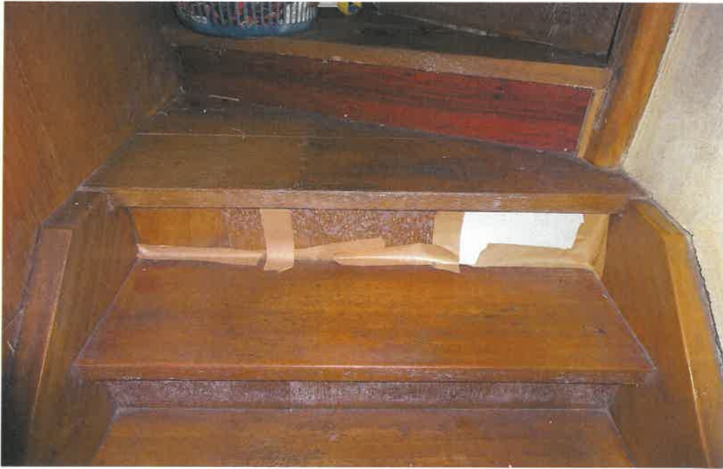
物件3(階段の破損箇所)
