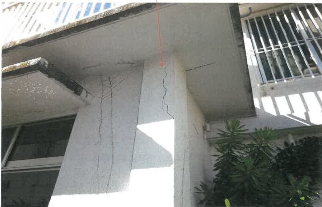
物件3 (コンクリートにできたクラック)
