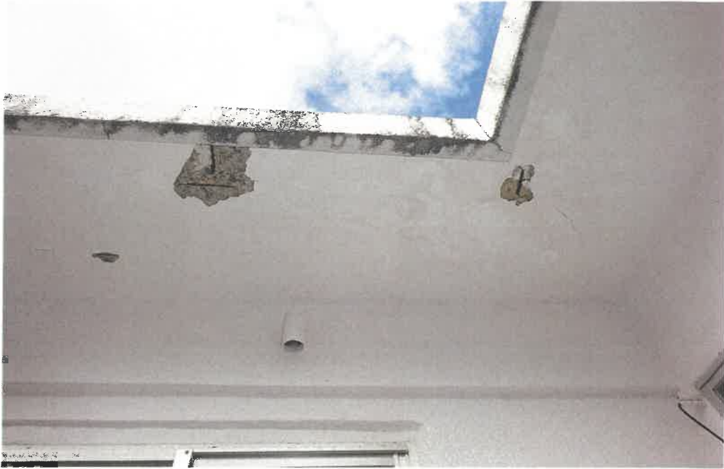
物件3 (コンクリートの破損箇所)
