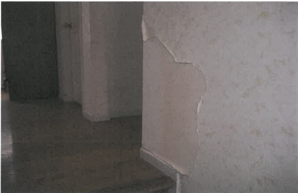
物件2の室内(2階:壁紙の剥がれた箇所)
