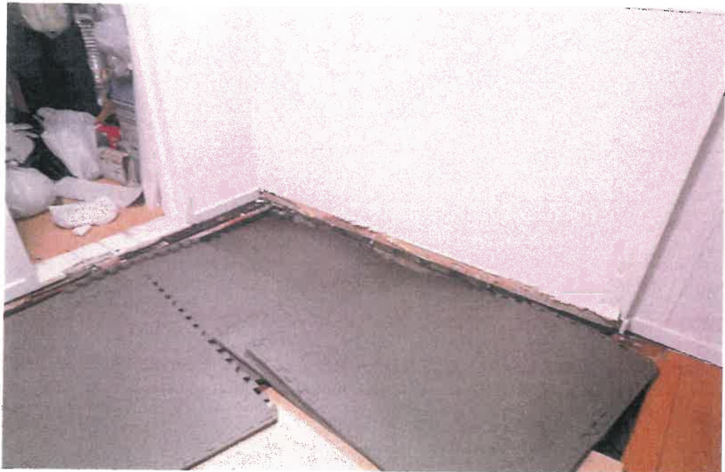
同上(床板の損傷状況)
