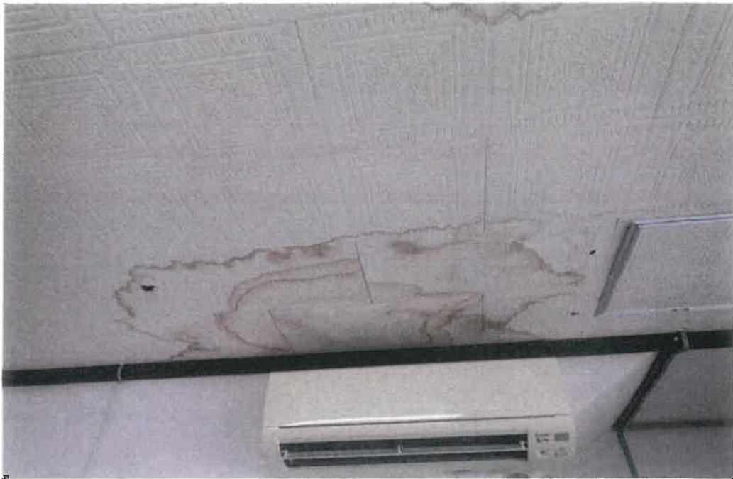
本件建物内部(水漏れ痕)
