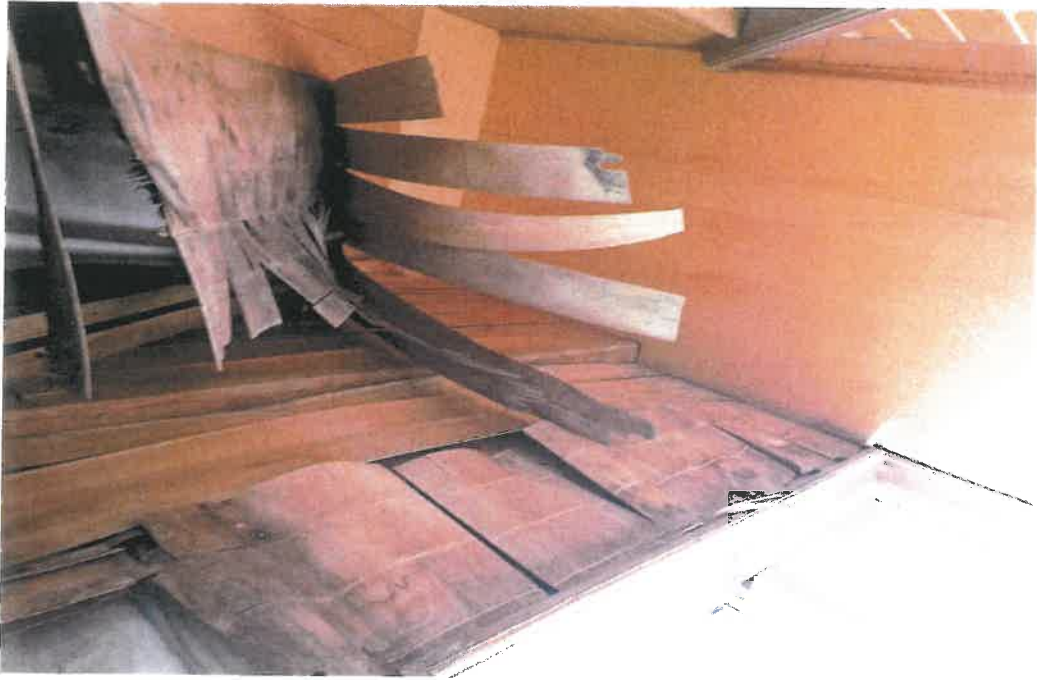
本件建物内部(天井板の損傷状況)
