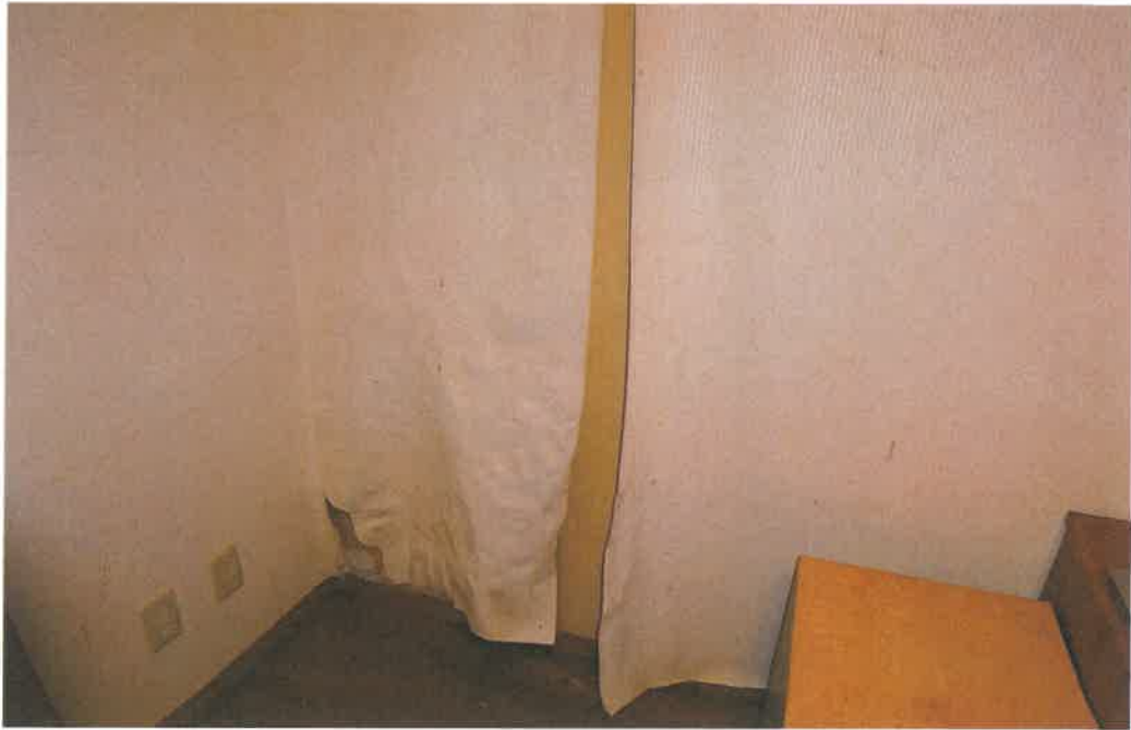
物件2の室内(壁紙が剥がれた箇所)
