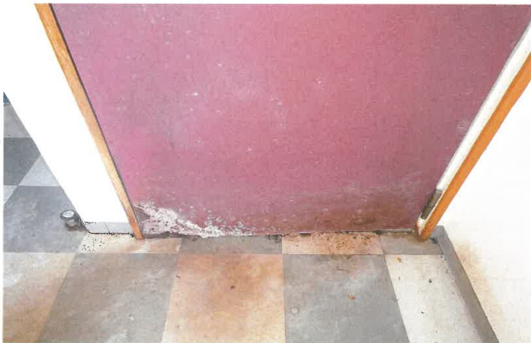
同上(ドアの腐食部分)
