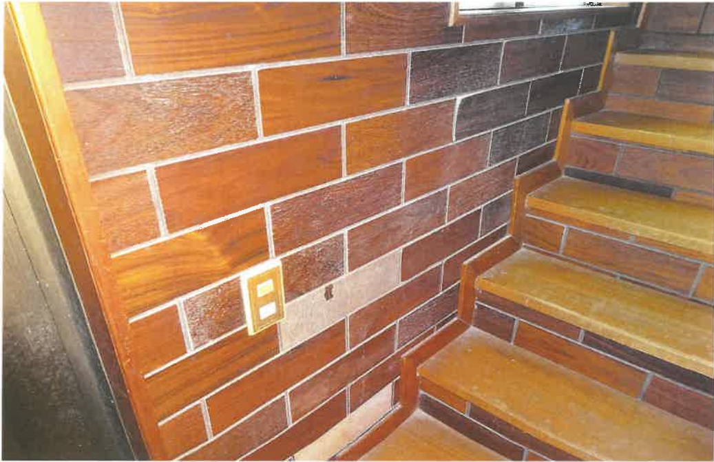
物件5の室内(壁板の剥がれた箇所)
