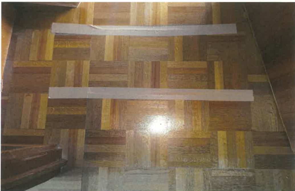
物件5の室内(床板の軋む箇所)
