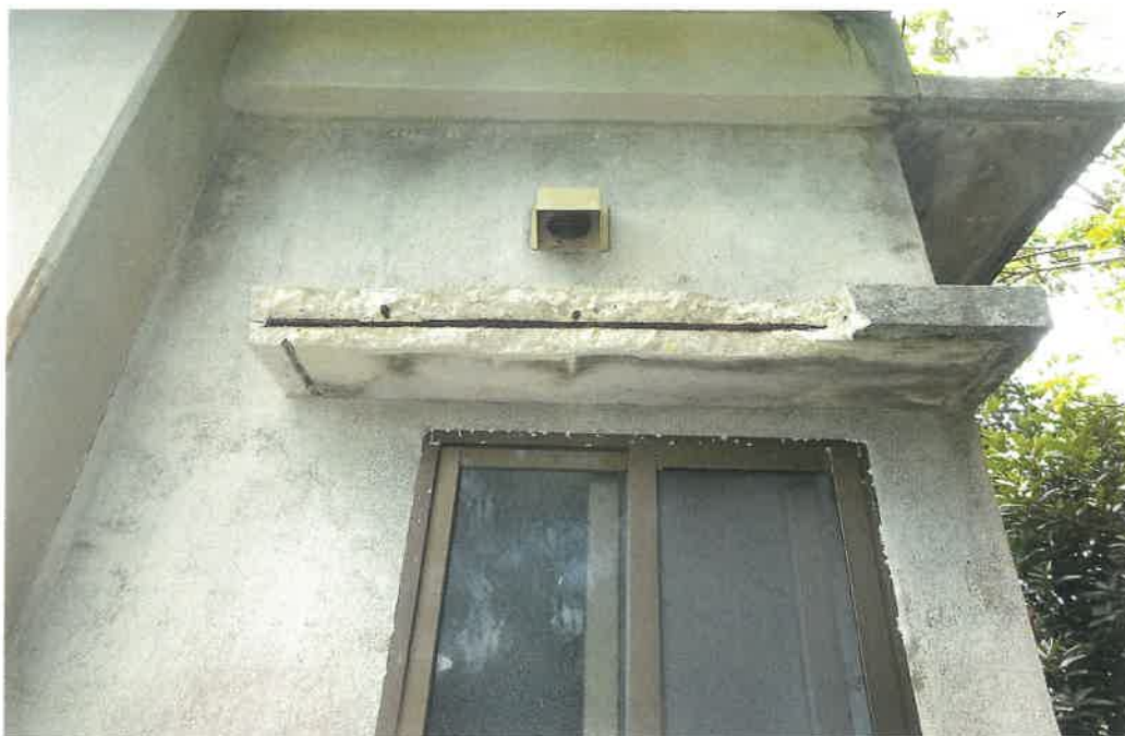
物件2(コンクリートの剥がれた箇所)
