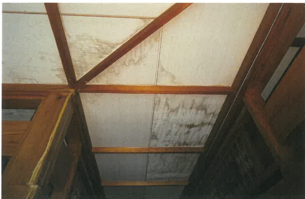
物件2の室内(雨漏り痕)
