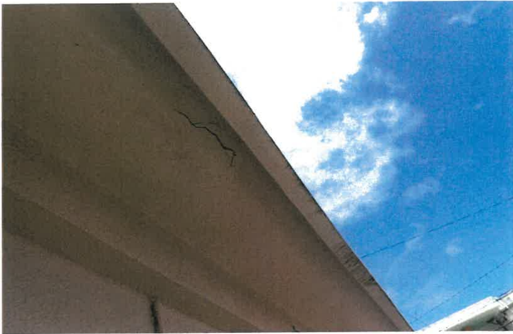
コンクリートのひび割れ等
