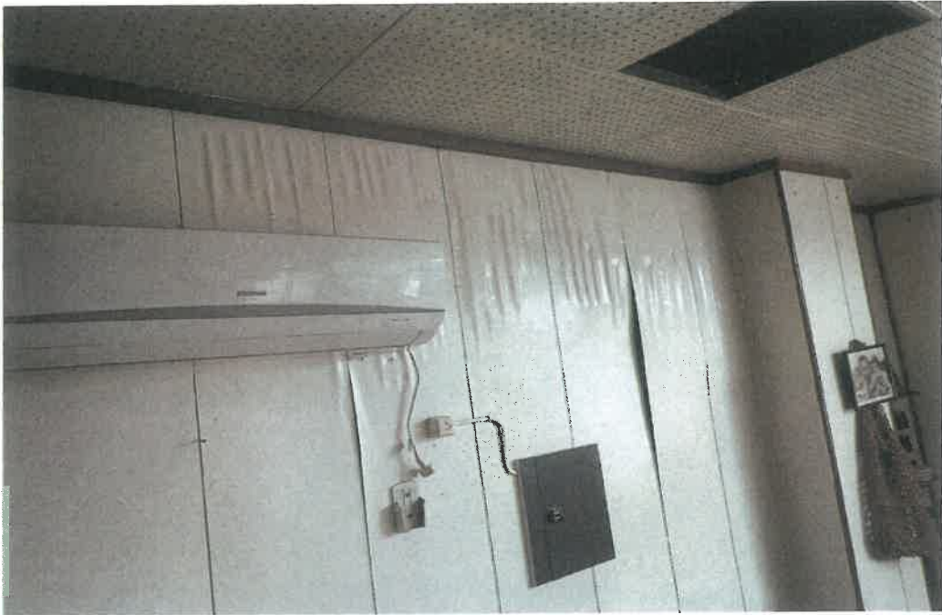
本件建物内部(3階・湿気による壁の損傷)
