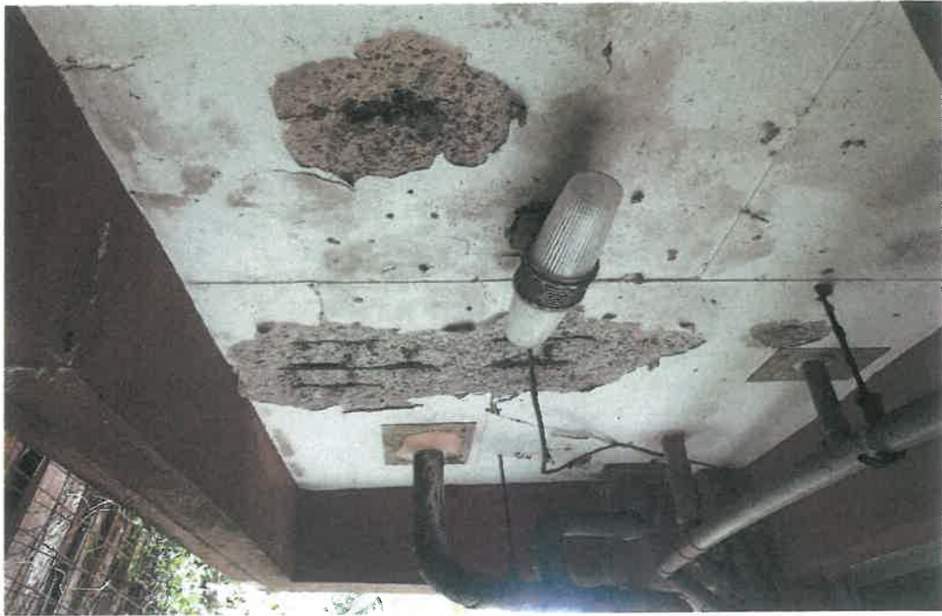
コンクリートの欠落状況
