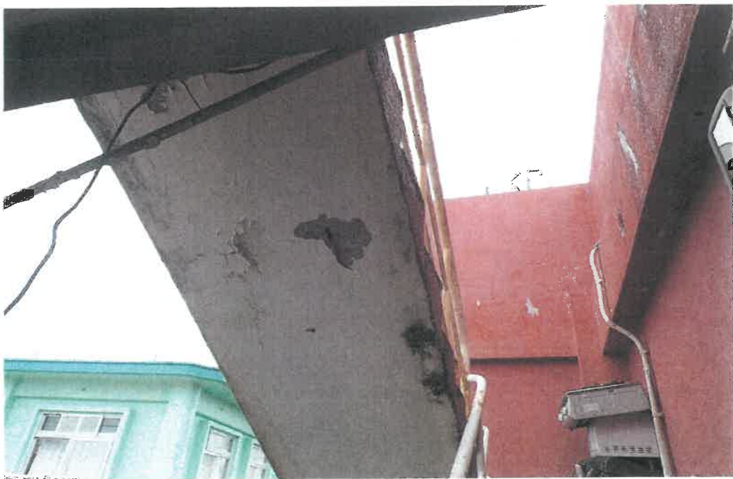
コンクリートの欠落状況
