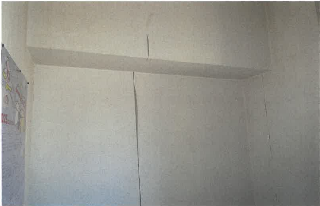
物件1の室内(壁紙の剥がれた箇所)
