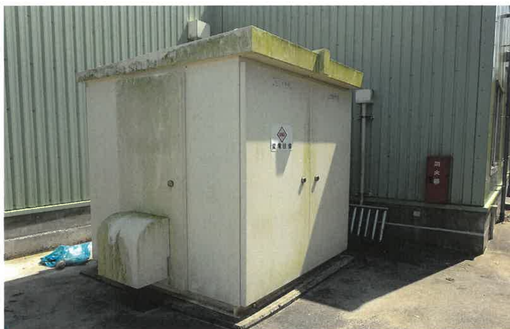
物件1にある変電設備
