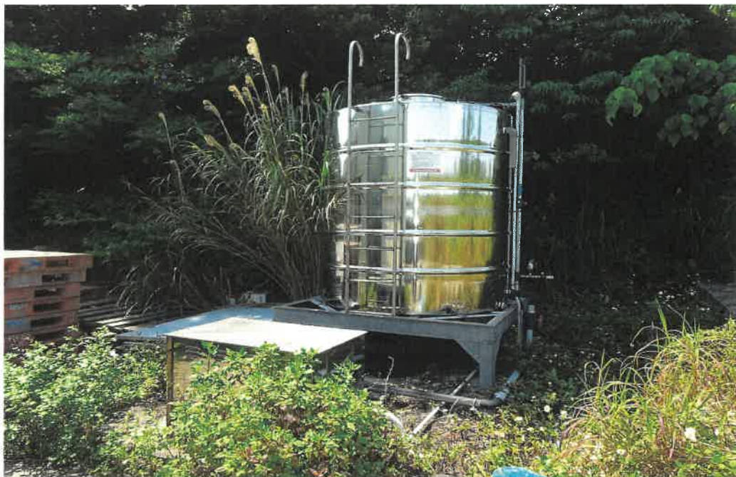
物件1にある水タンク
