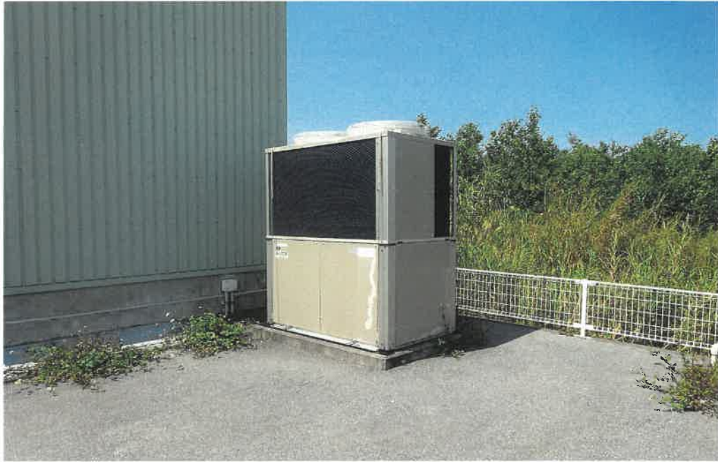
物件1にあるガスヒートポンプエアコン
