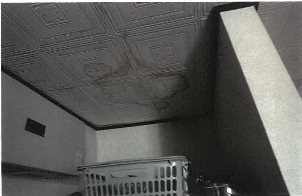
同上(水漏れ痕)
