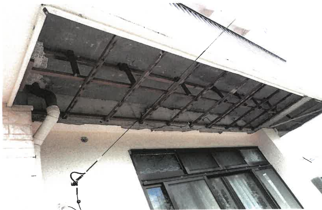
底下の損傷状況
