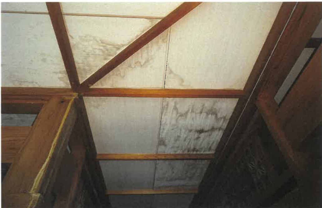
物件2の室内(雨漏り痕)
