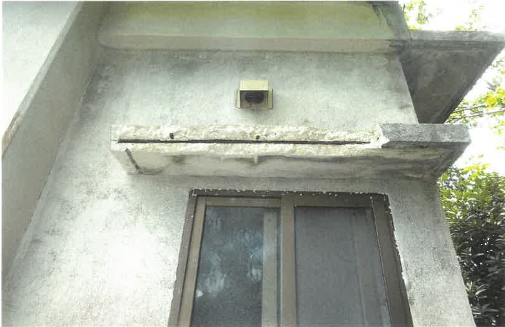
物件2(コンクリートの剥がれた箇所)
