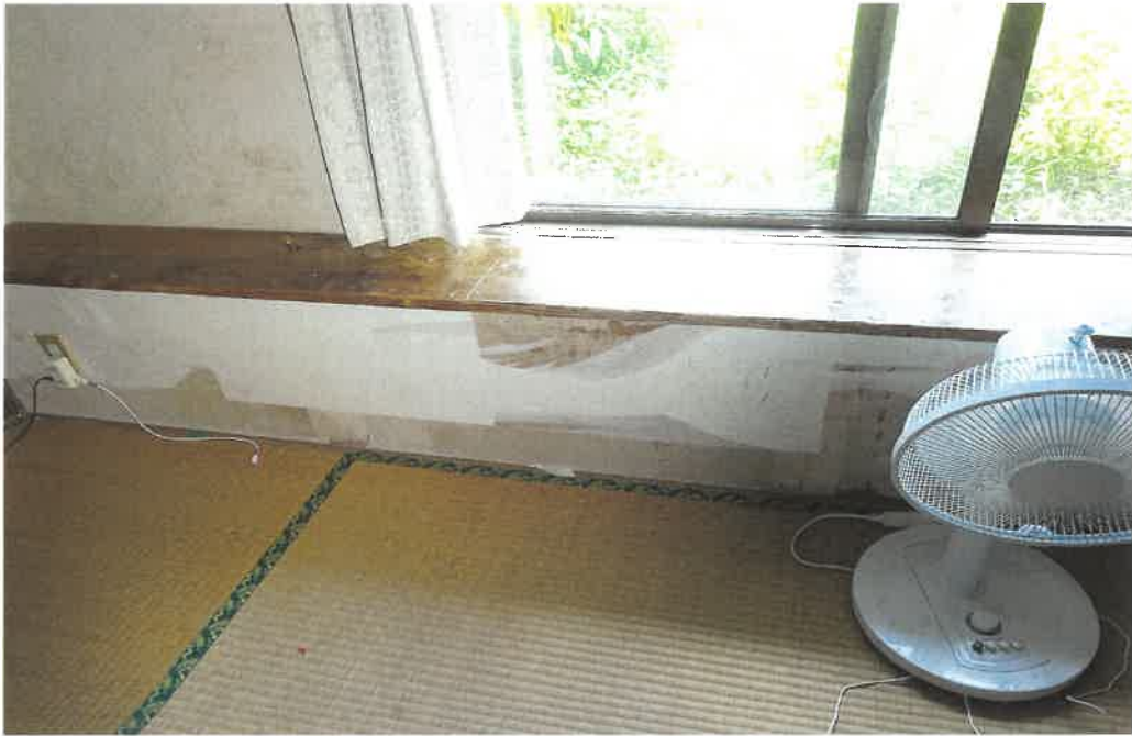
物件2(壁紙の剥がれた箇所)
