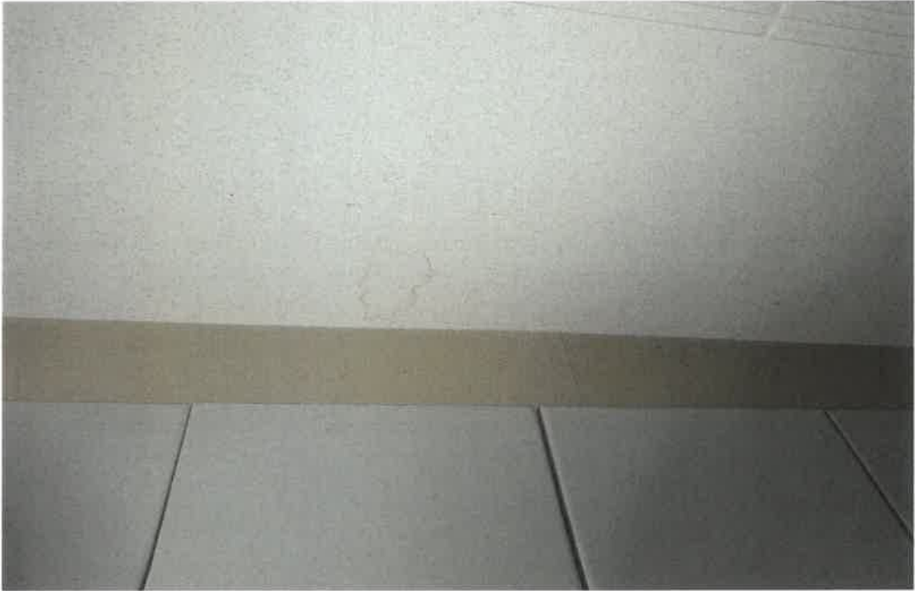
物件2(雨漏り痕)
