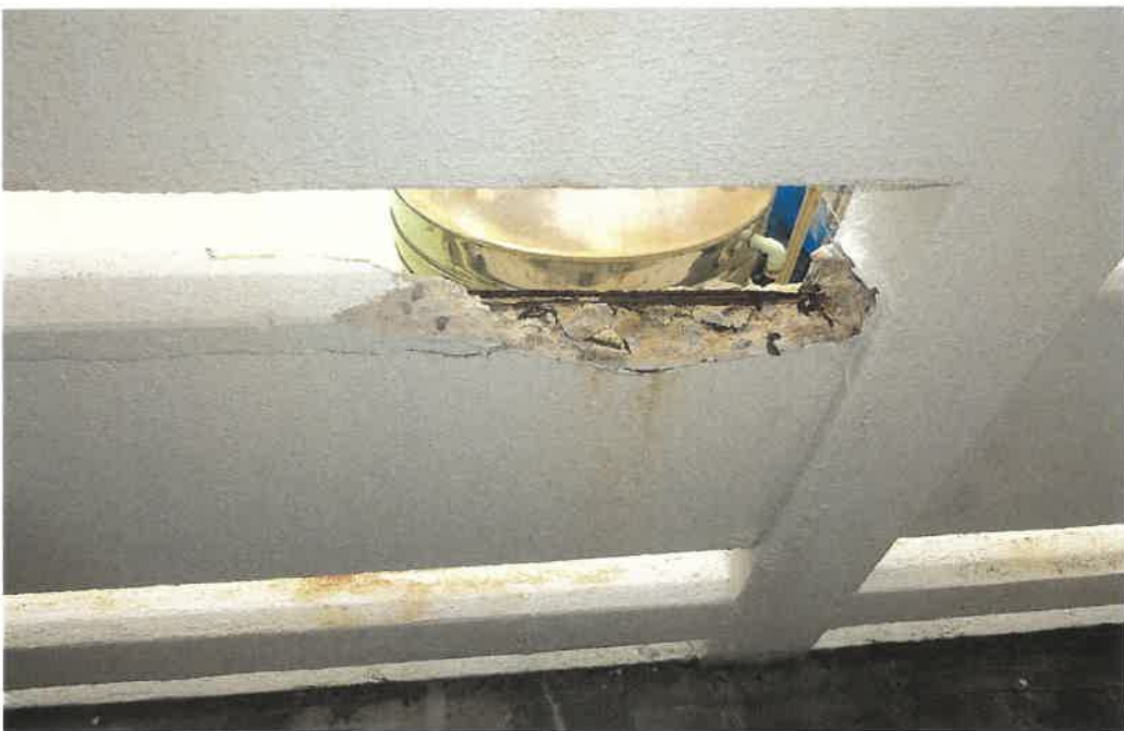
物件2(コンクリートが剥がれた箇所)
