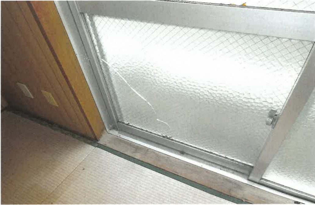
物件2の室内(窓ガラスのひび：302号室)
