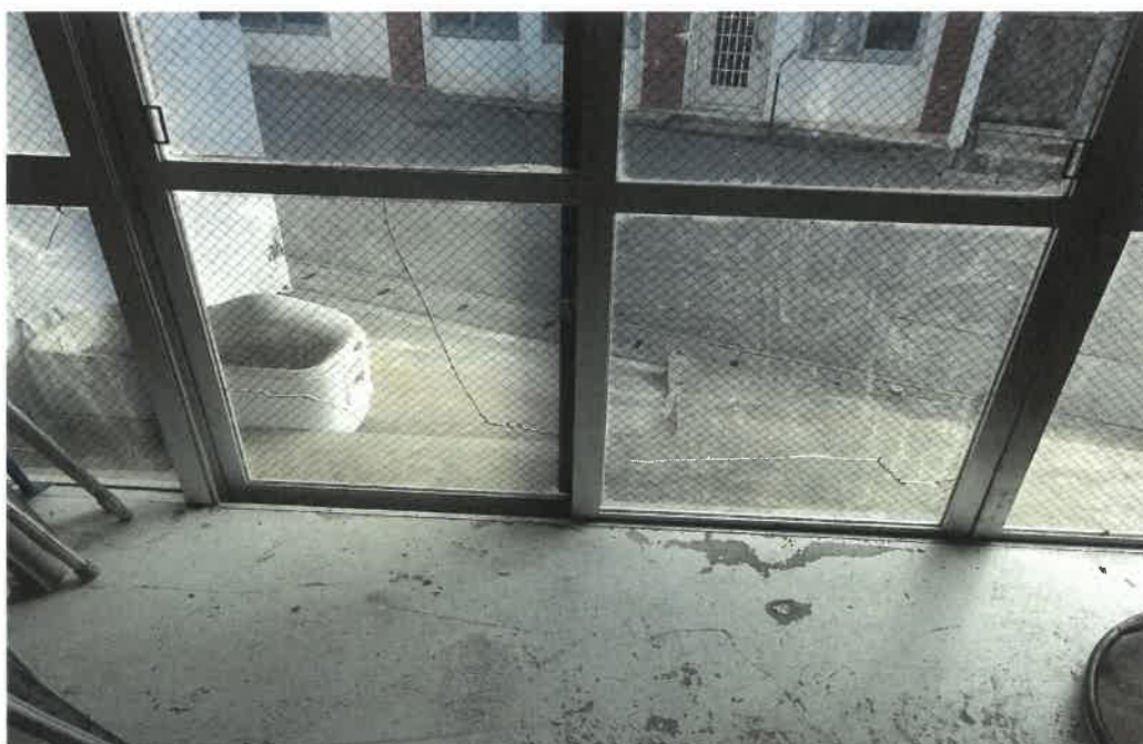
物件2(1階事務室:ひびのある窓ガラス)
