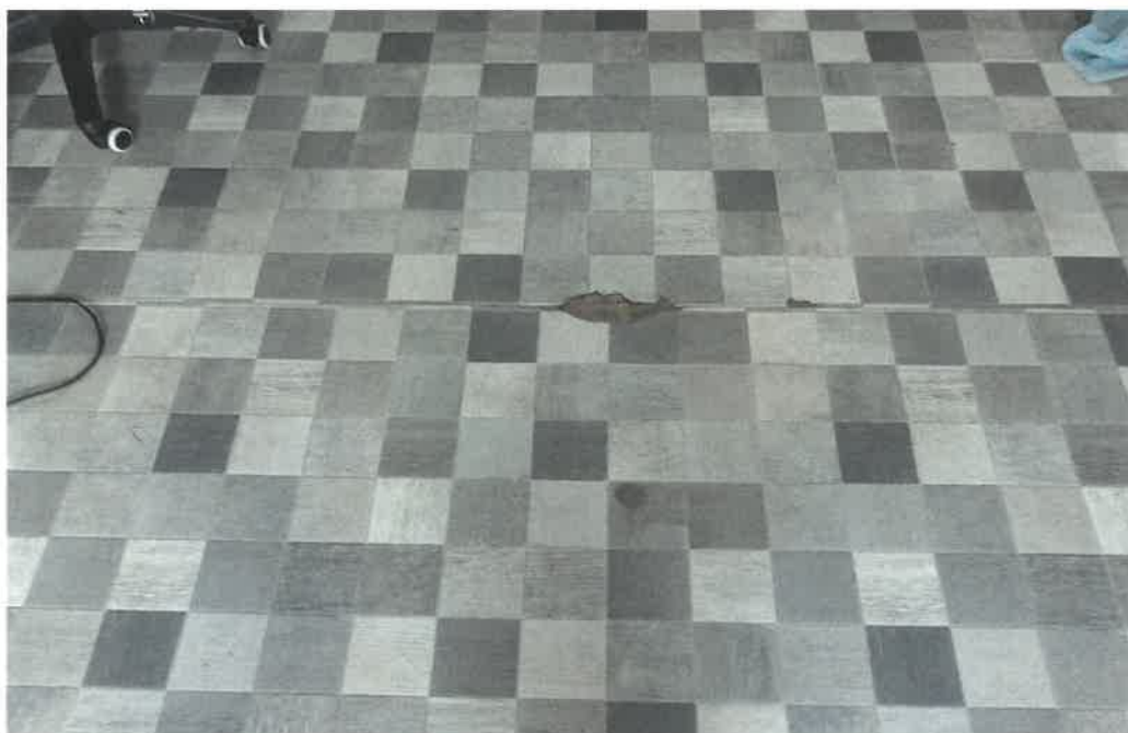
物件2の室内(2階:床の傷み)
