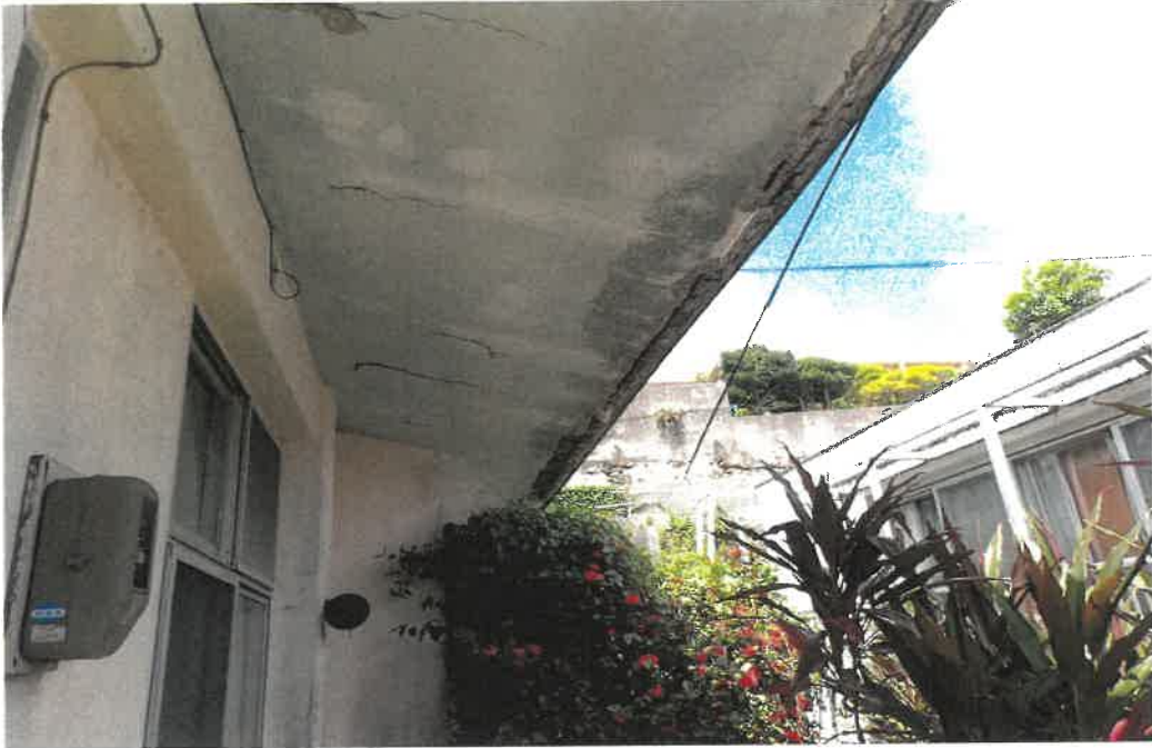
コンクリートの欠落等
