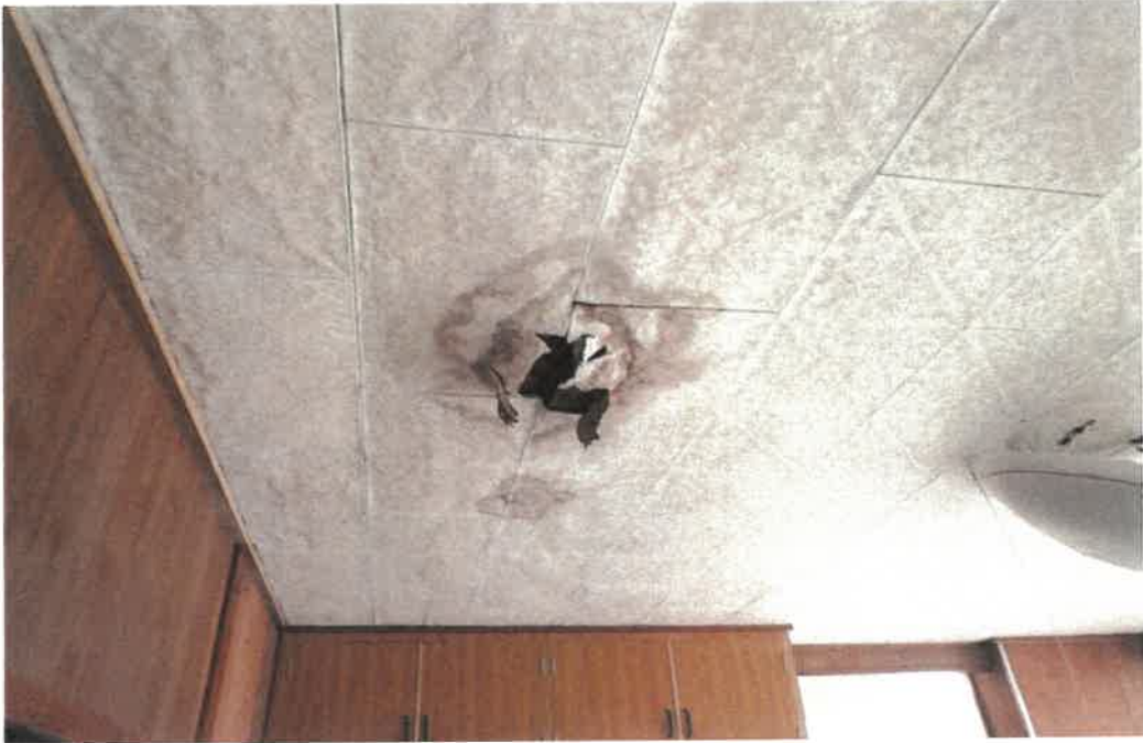
本件建物内部(天井板損傷状況)
