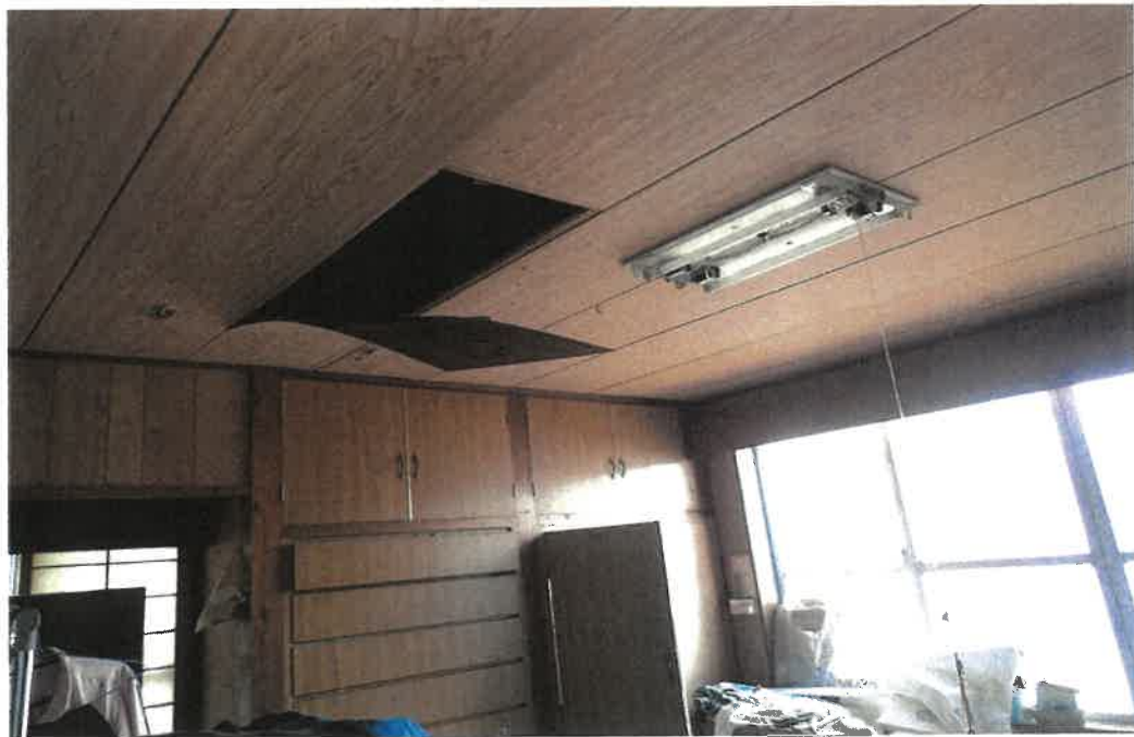
同上(天井板損傷状況)
