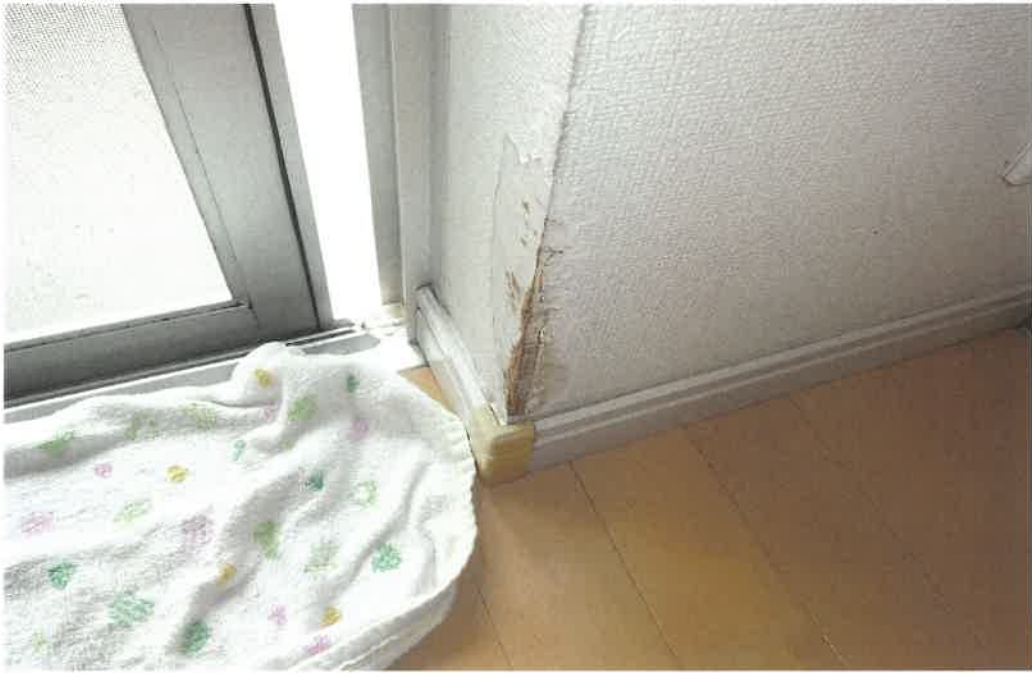
物件1の室内(壁にできた傷)
