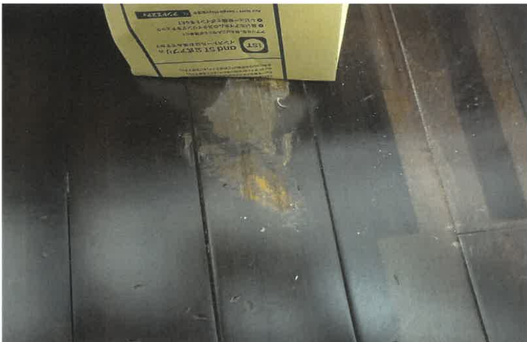
物件1の室内(床板の塗装が剥がれた箇所)
