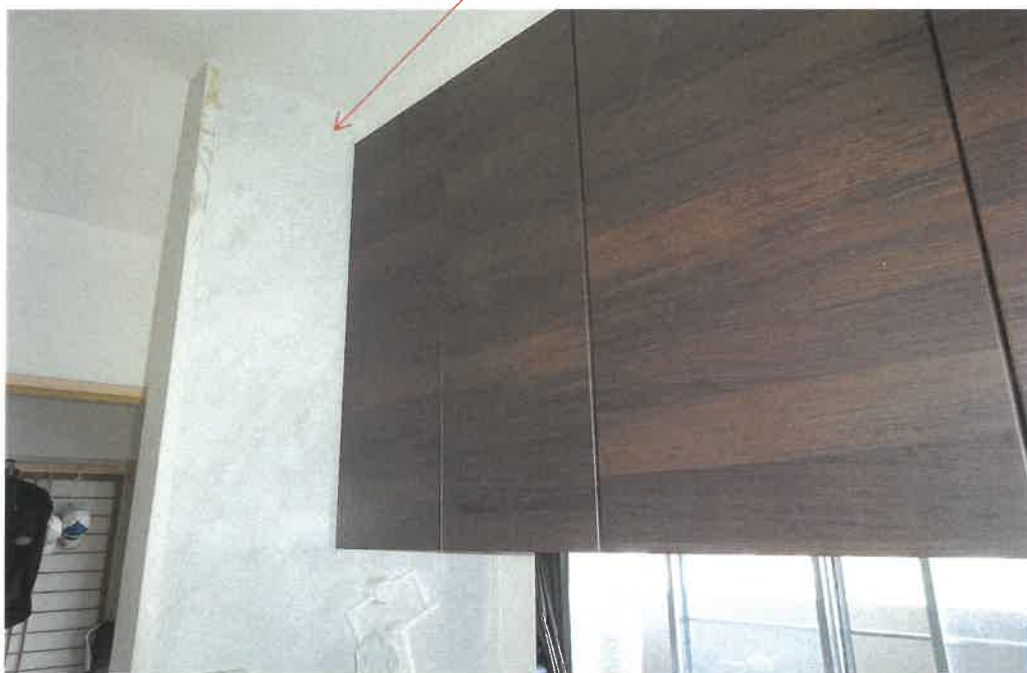
物件1の室内(雨漏り箇所)
