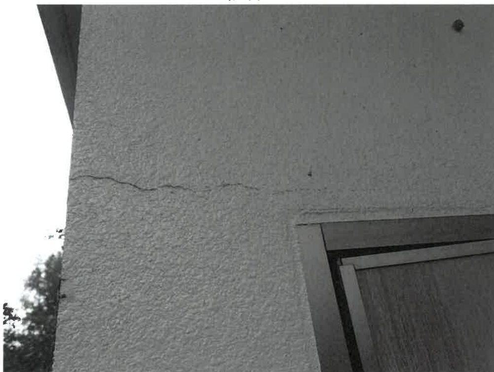
外壁にクラックが見られる箇所
