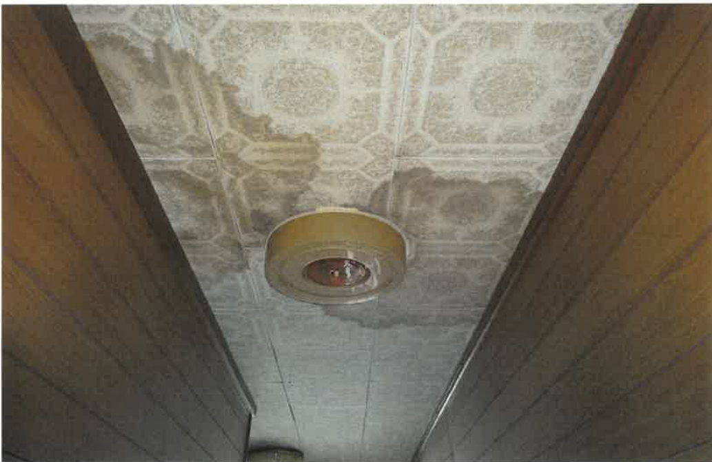
物件2の室内(雨漏りと思われる箇所)
