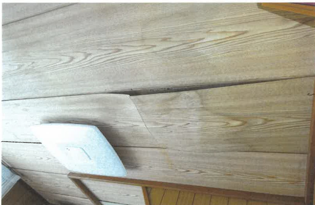
物件2の室内(雨漏りと思われる箇所)
