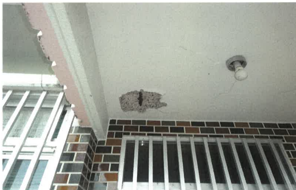
物件2(コンクリートの剥離した箇所)
