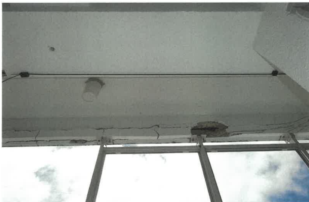
物件2(コンクリートの剥離及びひび割れ箇所)
