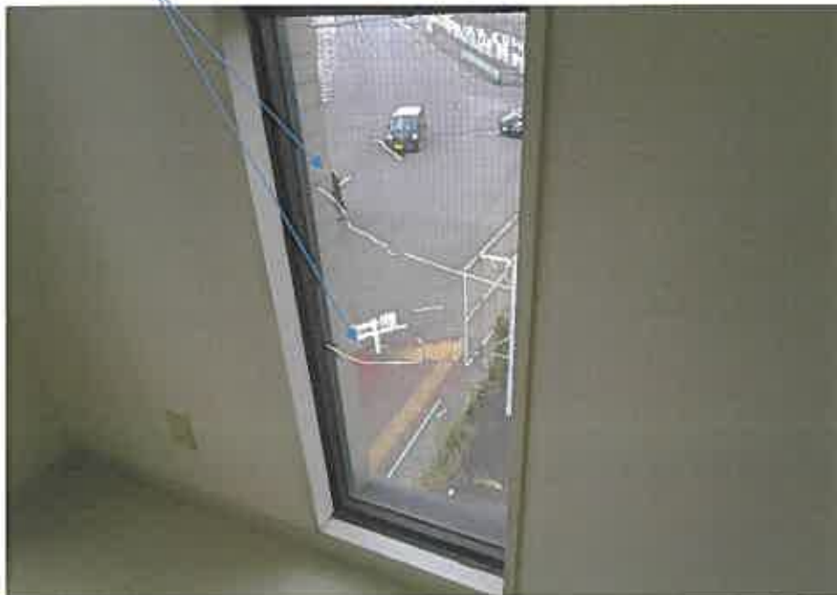
写真⑱ 303号室の窓ガラスの破損
