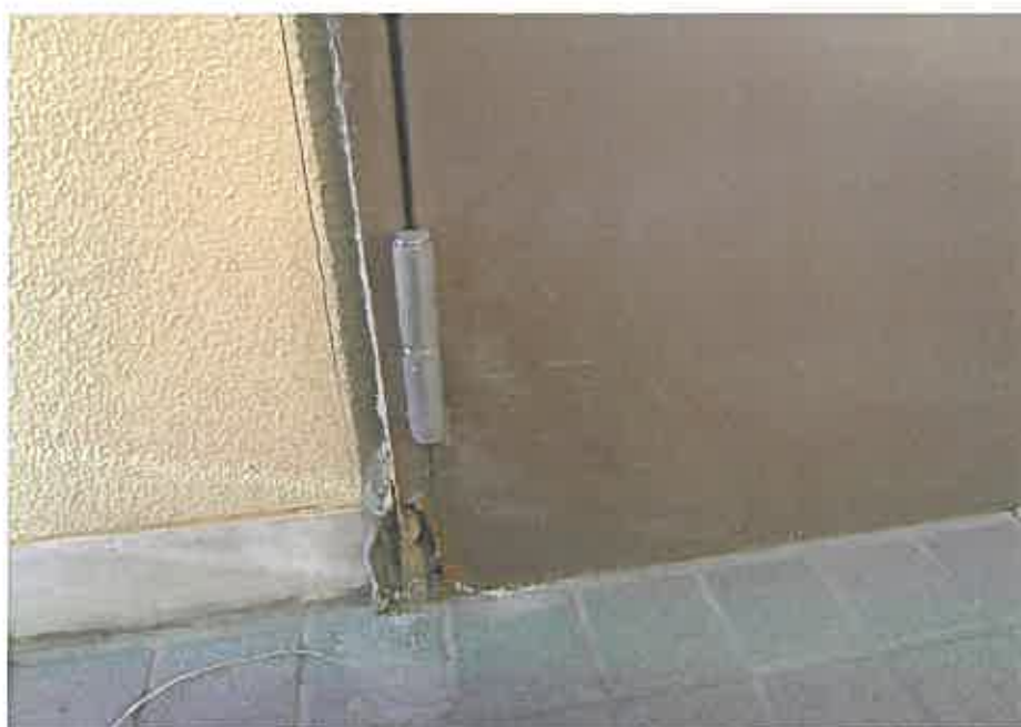
写真⑩ 103号室のドアの破損
