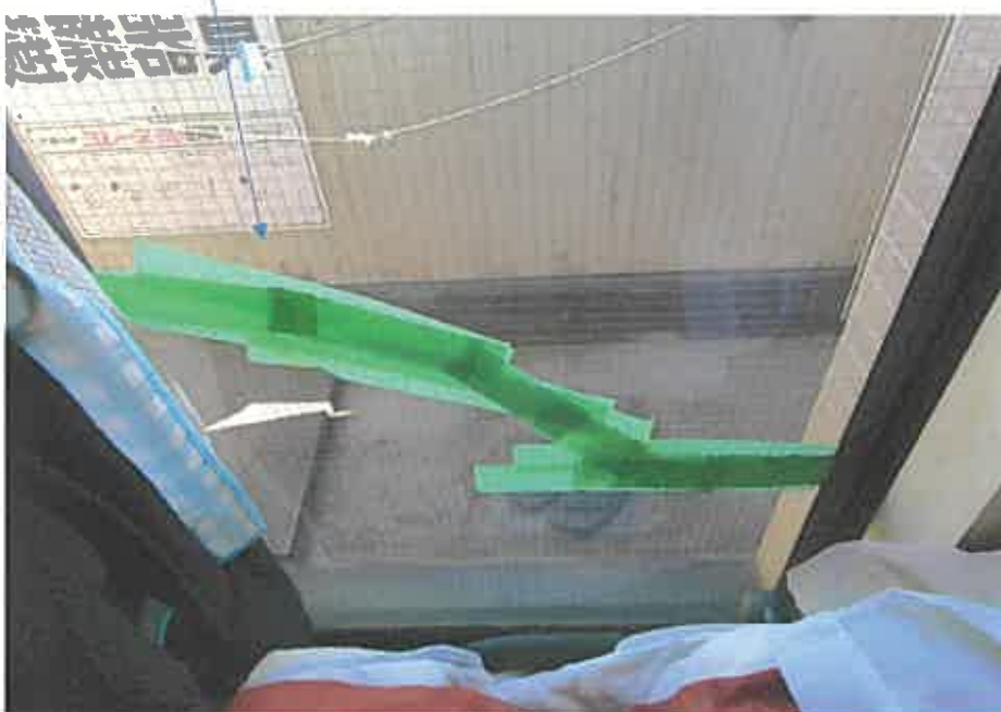
写真⑱ 302号室の窓ガラスの破損
