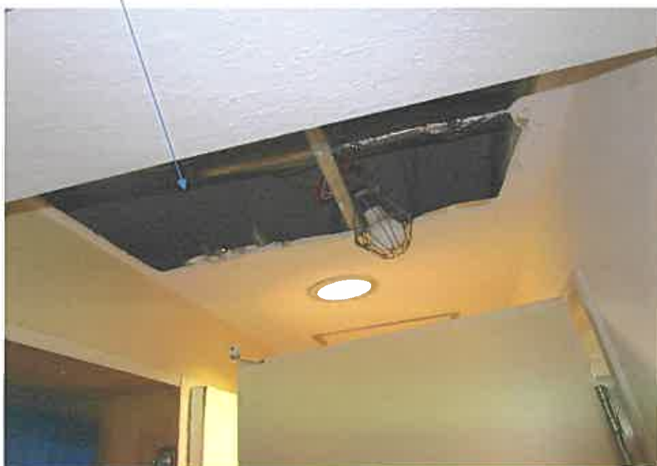
写真⑫ 天井の破損
