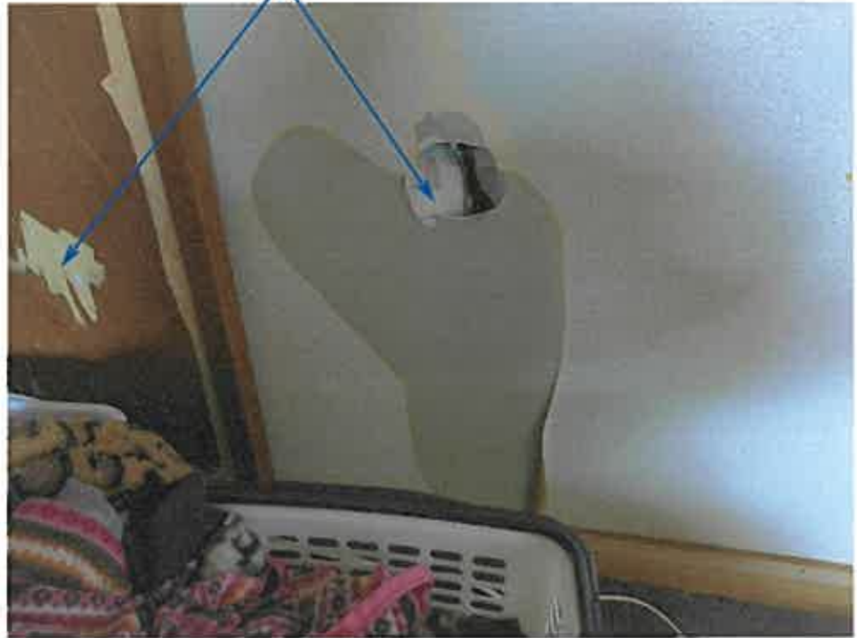
写 真 7 猫による損傷箇所
