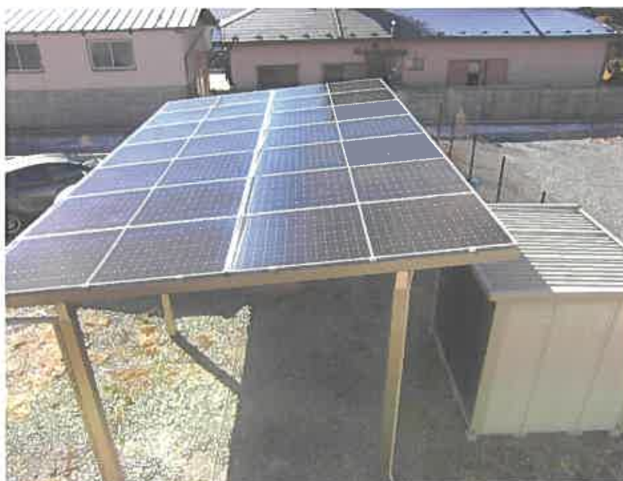
写真 8 カーポートの屋根(ソーラーパネル設置)
