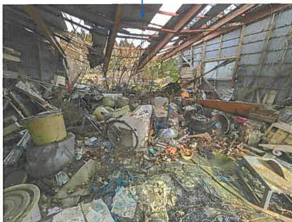
写 真 1 0 損壊している物件4の屋根
