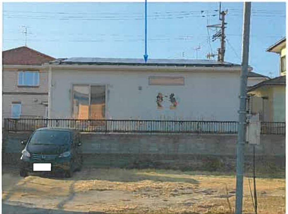
写 真 2 太陽光パネル
