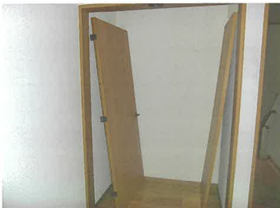
写真 8 クローゼットの扉が外れている状況
