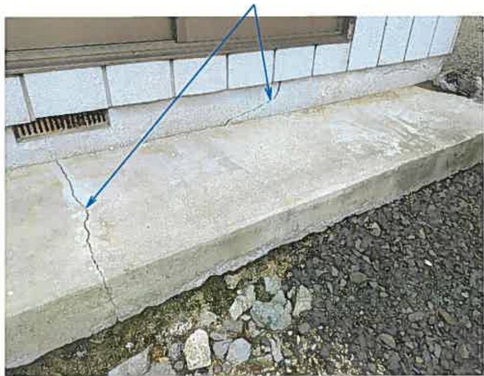
物件 2 の基礎部分等の亀裂
