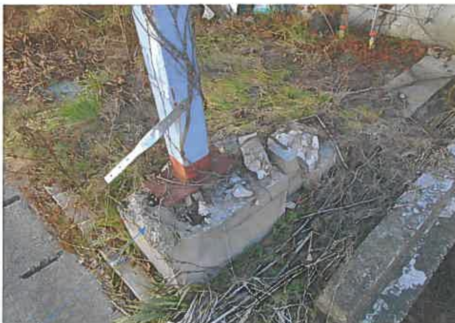
外階段の支柱の破損
