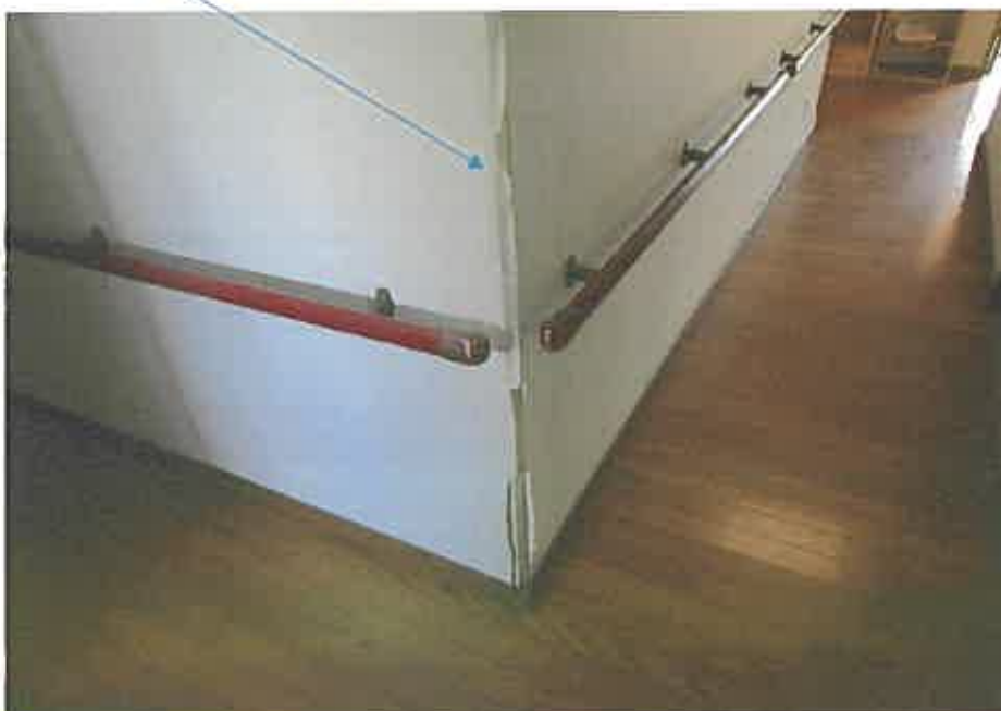
写真⑱ 内壁クロスの損傷
