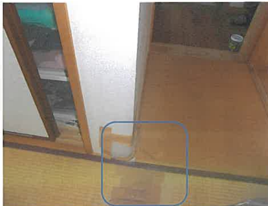
写真 6 床や内壁の損傷状況
