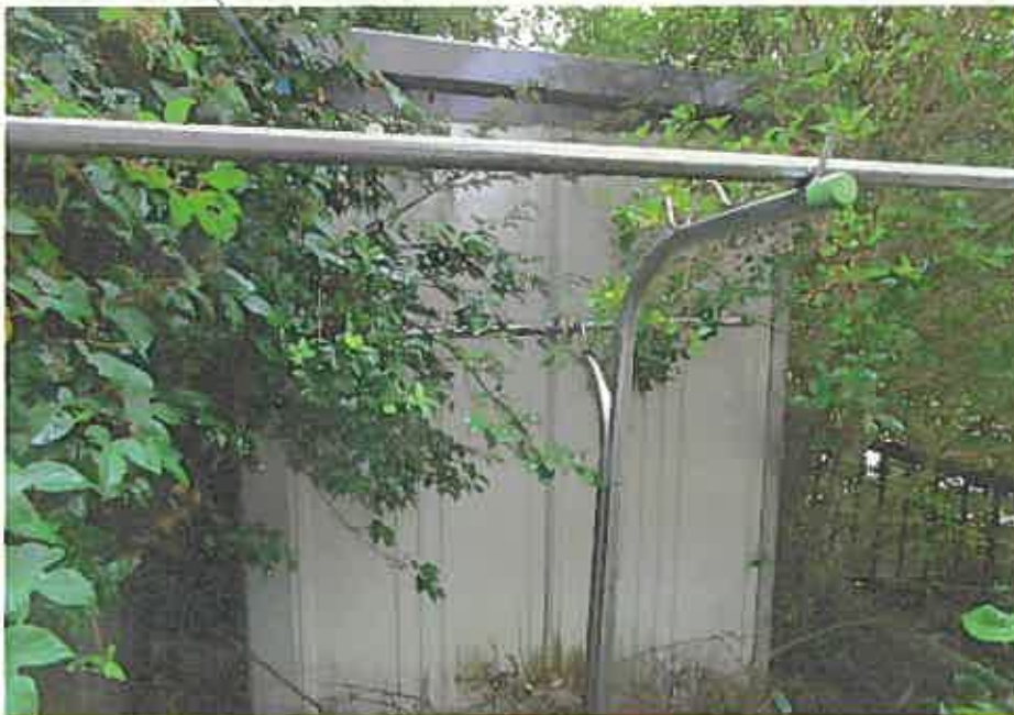
写真② スチール製物置(動産)
