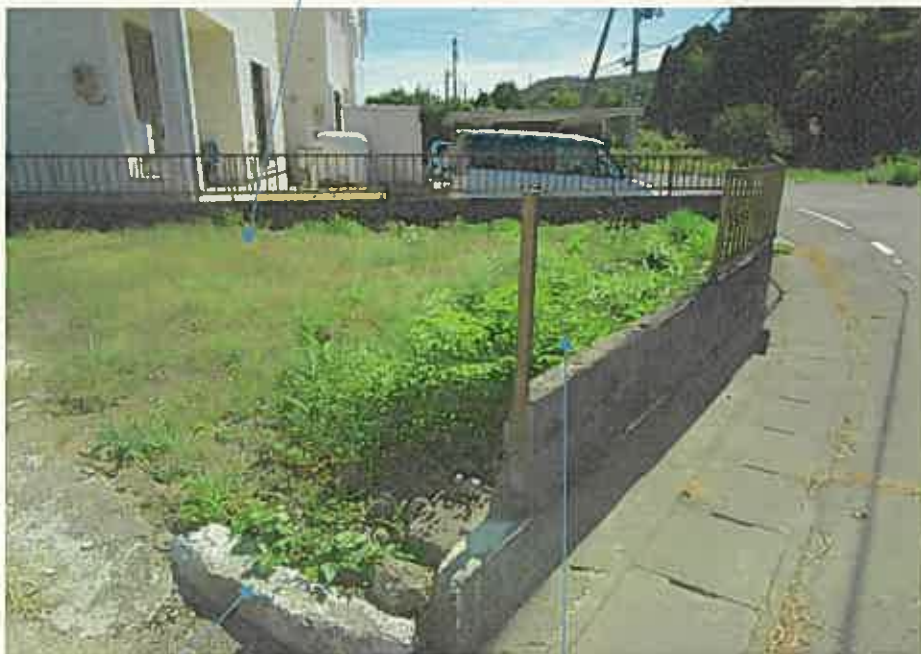
コンクリートブロックの損傷
