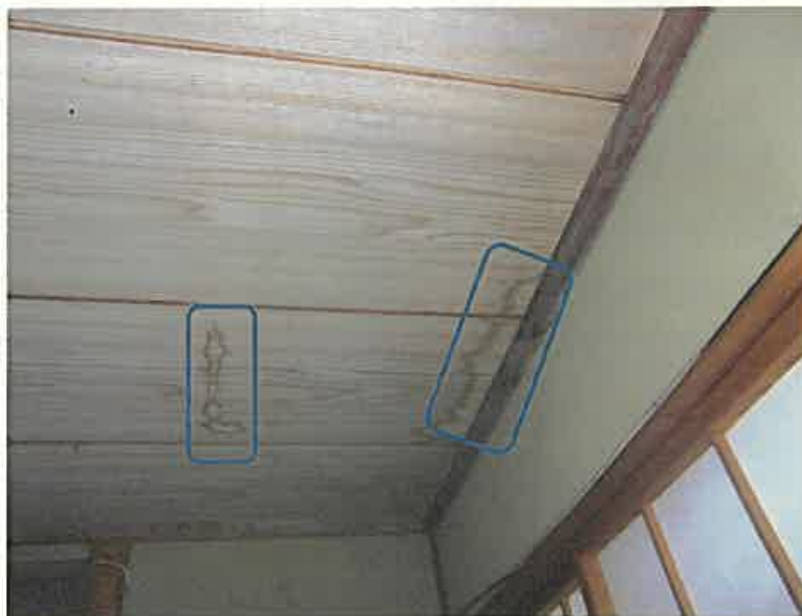
写真 9 雨漏り後の状況
