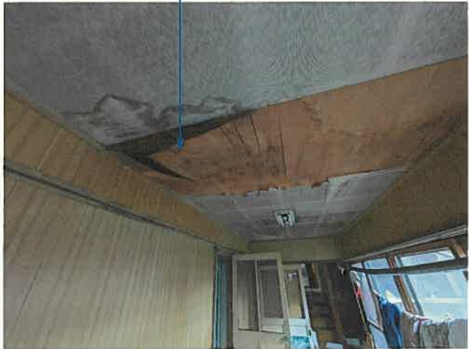
写 真 7 天井の破損部分
