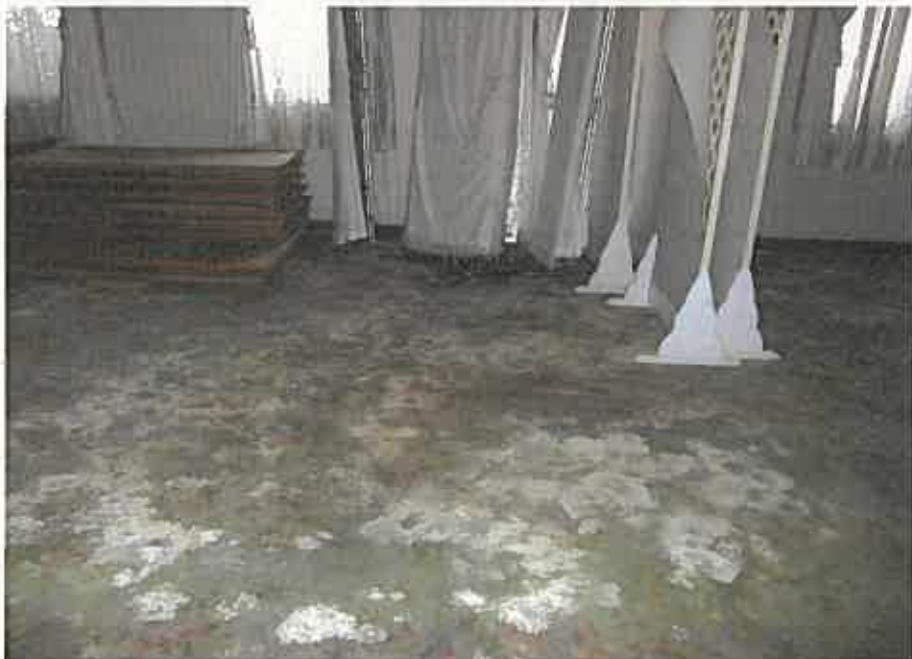
写真 30 雨漏りにより床の絨毯が汚損している状況
