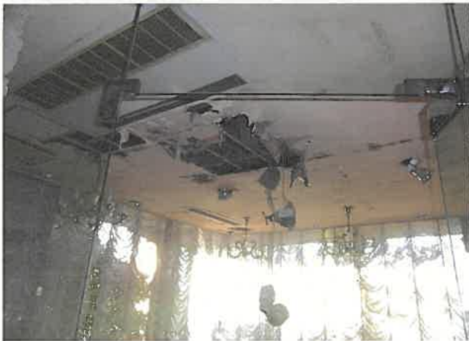
写真 16 雨漏り跡及び天井の損傷状況
