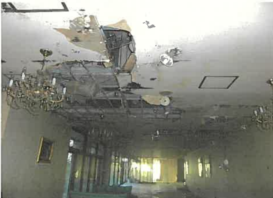
写真 18 天井の損傷状況
