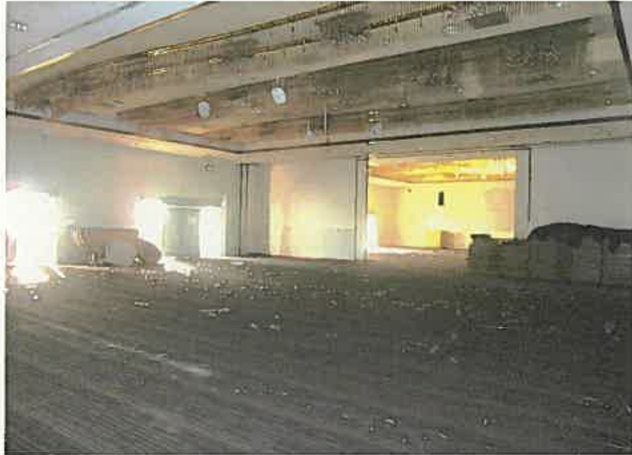
写真 29 天井に吊されたガラス飾りが床に散乱している状況
