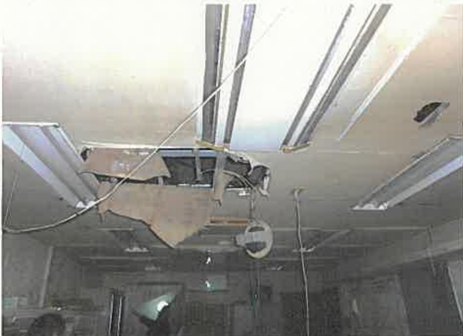
写真 22 天井の損傷状況
