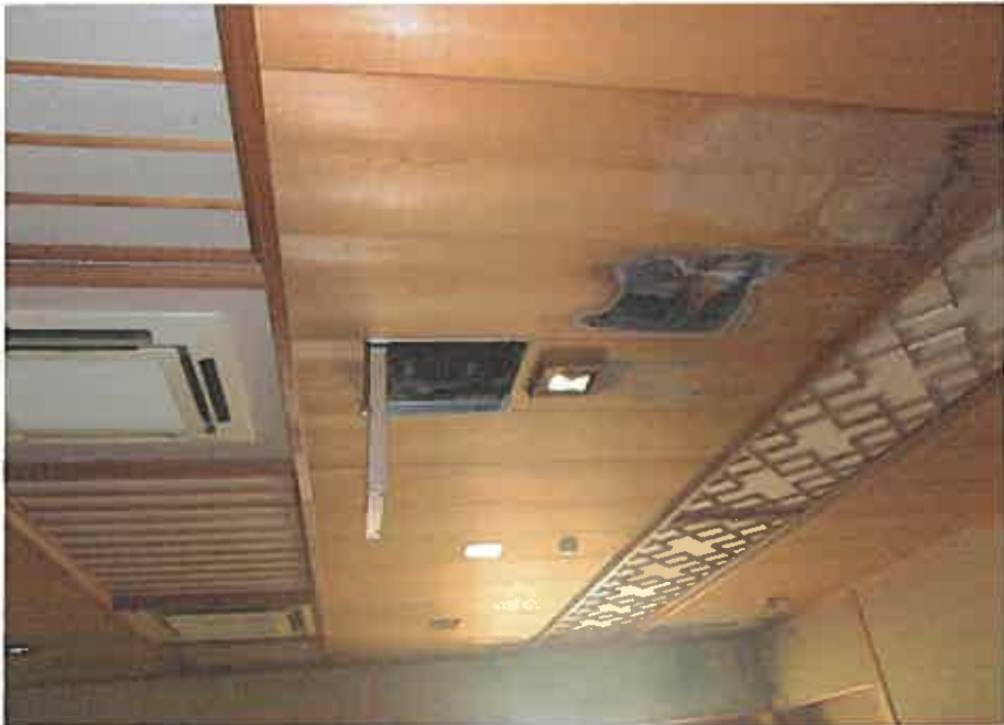
写真 4 雨漏り跡及び天井の損傷状況
