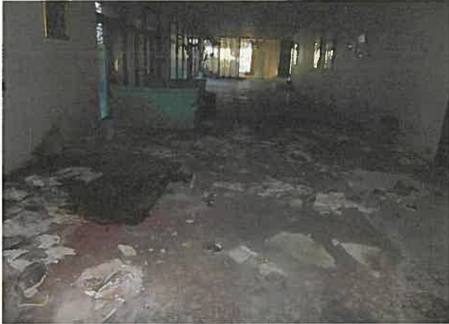
写真 17 天井板等が床に散乱している状況
