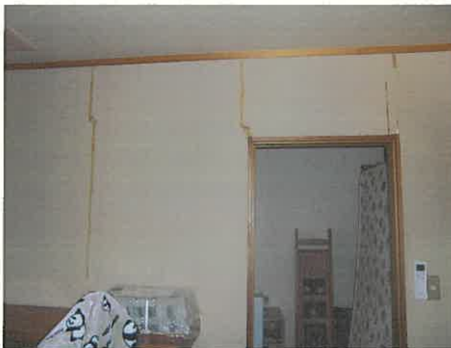
写真 9 内壁の亀裂の状況
